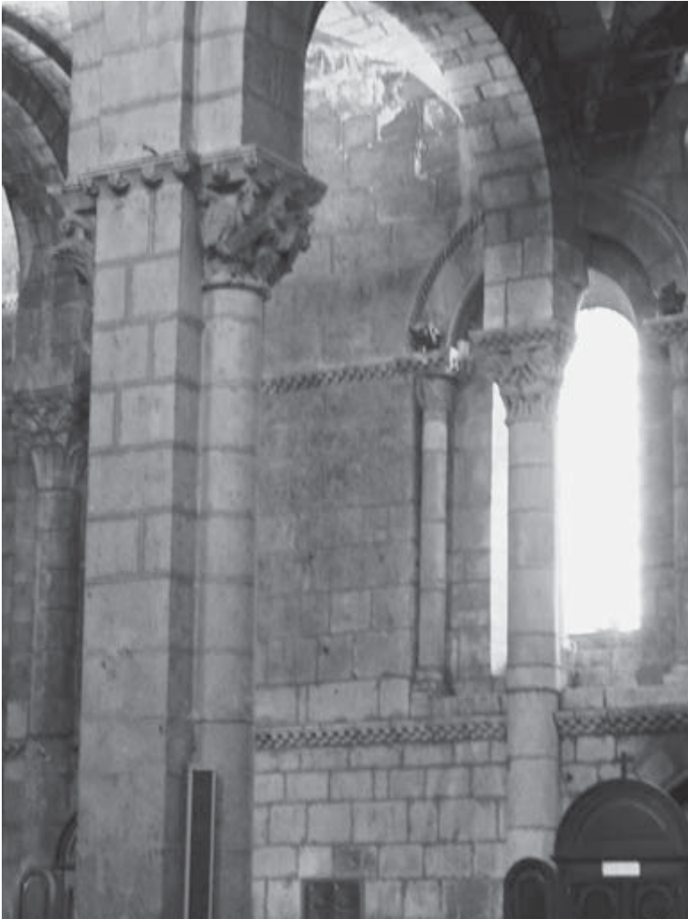
Figura 22. Llamativa anomalía constructiva existente en la Colegiata de San Isidoro de León, con un soporte pasando por delante de una ventana (foto del autor).
